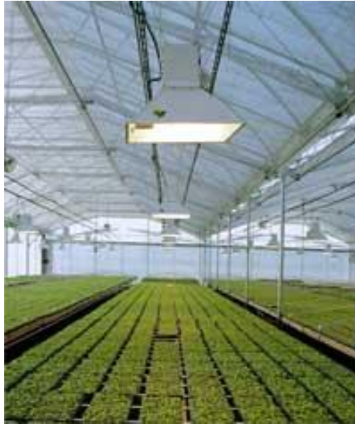
Figure III. 22: Exemple d'éclairage artificiel [W19].
