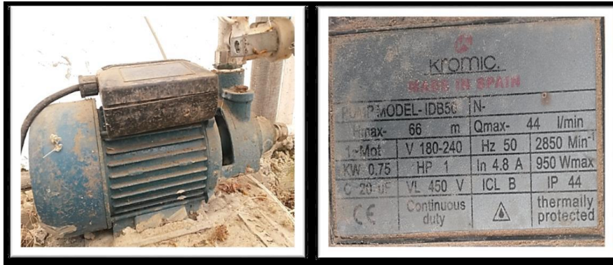
Figure III. 16: Pompe à eau [17].
