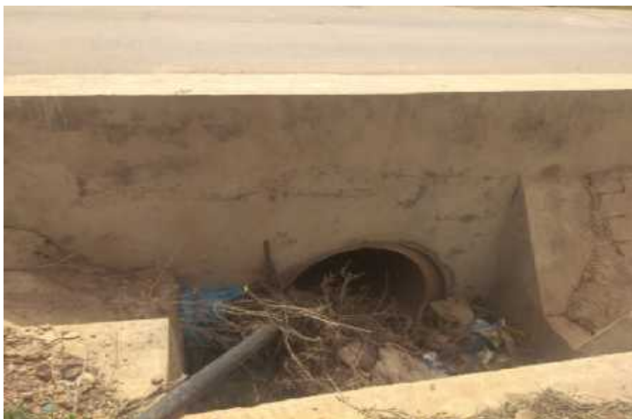
_FIGURE 12 : CONDUITE DE REFOULEMENT TRAVERSE LES BUS D'ASSAINISSEMENT
