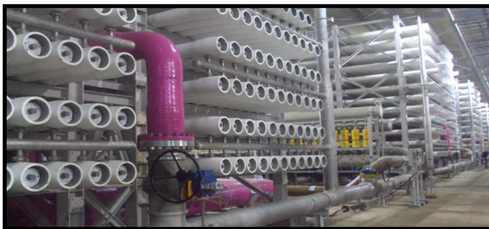
Photo 7 : les modules de l'osmose inverse (Racks).
