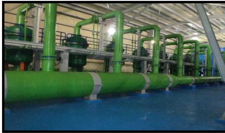
Photo 4 : Les filtres à cartouches.
