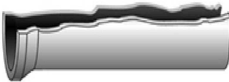
Figure 22 : Fissure dans les joints de soudure.[19]
