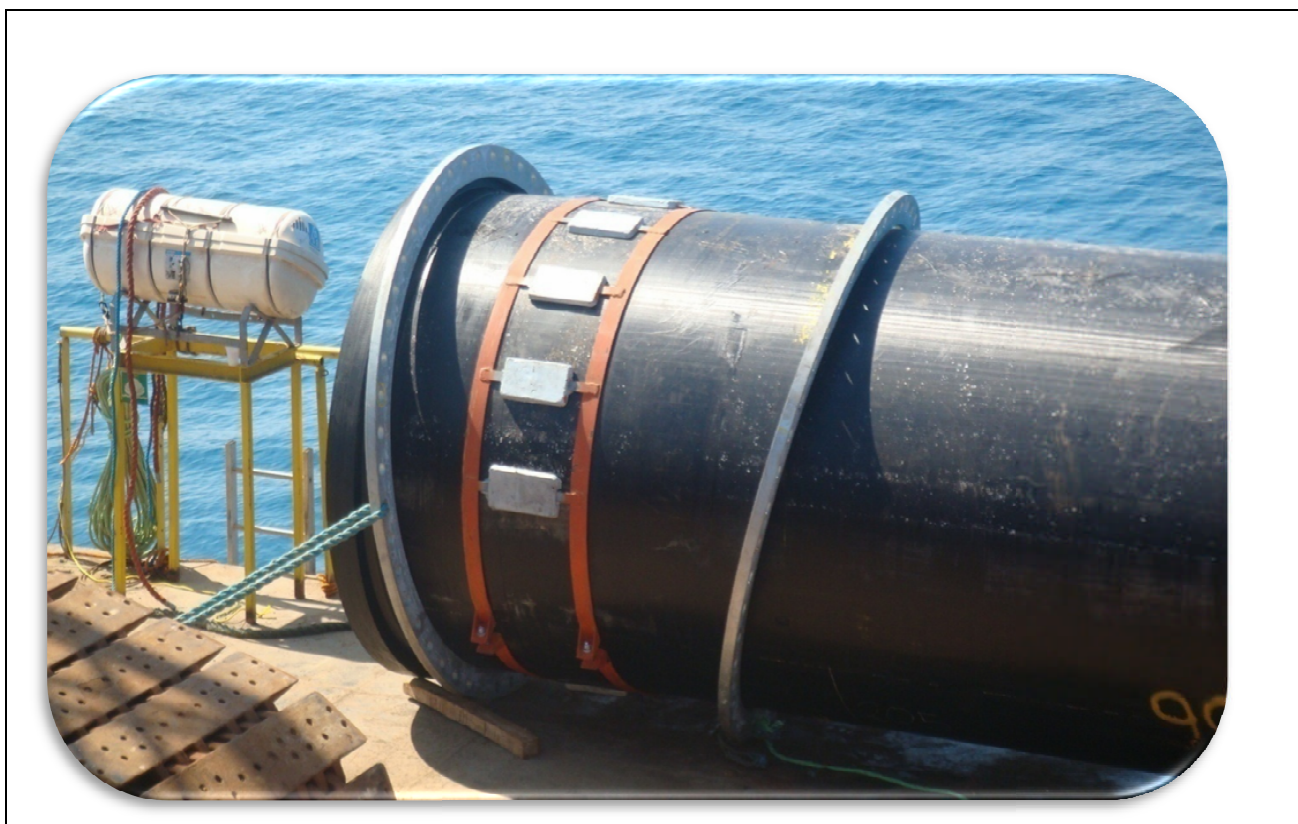
Figure III-12 Les Manchettes offshore connecté avec les anodes sacrificielles
