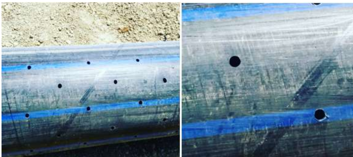
Figure N° 37 : Les tuyaux perforés en PEHD.
