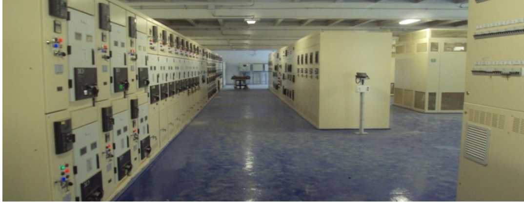
« Photo III.14 » : la salle d'électricité de la SDEM de Béni Saf
