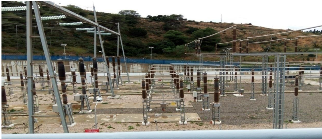
« Photo III.15 » : le réseau électrique de la SDEM de Béni Saf
