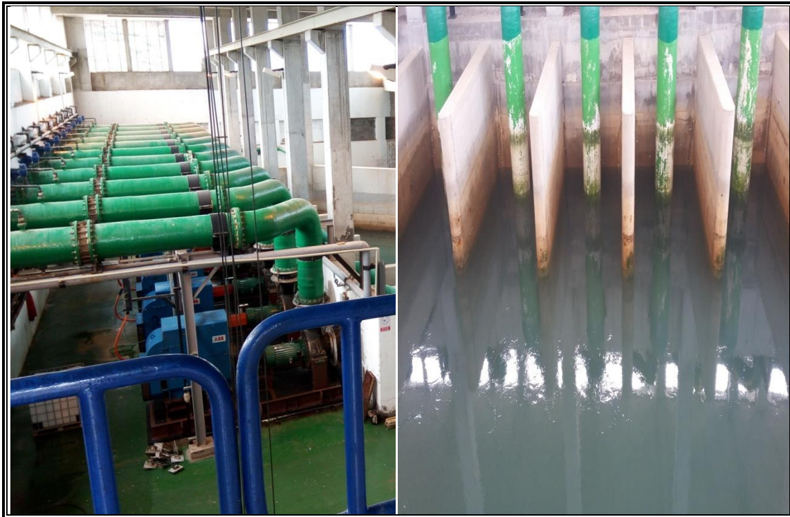
« Photo III.3 » : pompes de pompage et bassin de stockage
