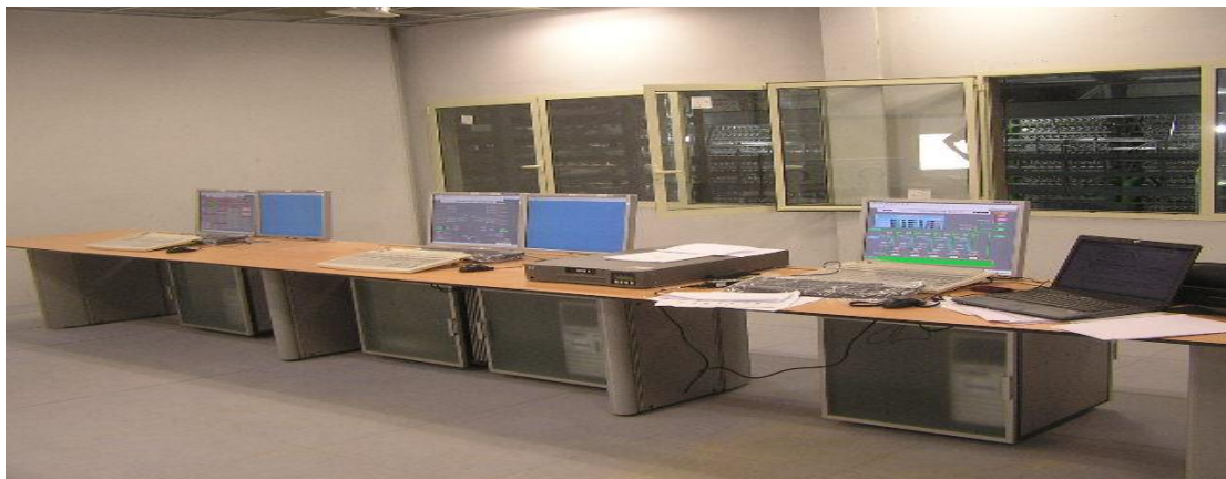
« Photo III.13 » : la salle de contrôle de la SDEM de Béni saf
