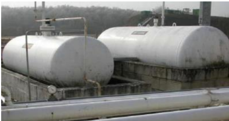
Figure 23: Les réservoirs horizontaux. [5]
